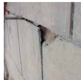
Obszar odspojenia boniowanych tynków imitujących okładzinę kamienną, które należy ustabilizować przez iniekcję.
